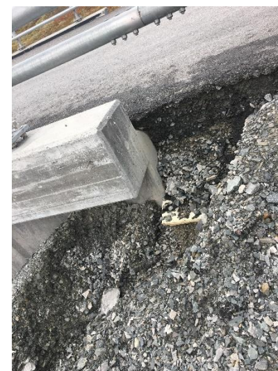
Vanlig erosionsskada -ände kantbalk
